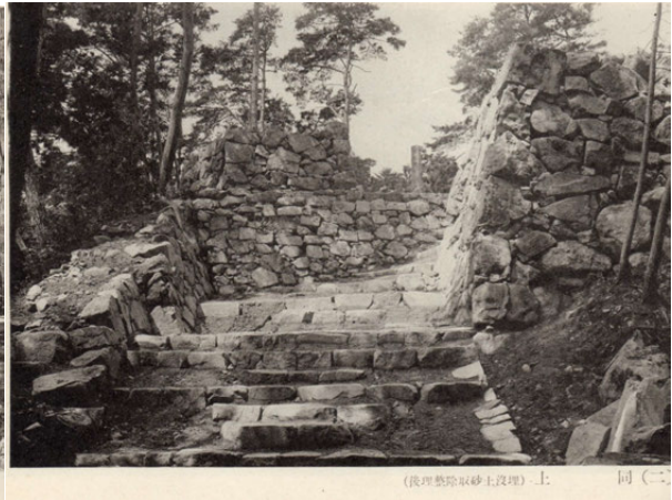
天主台登り口(二) (土砂取り除いた後の状態)
